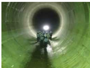
雨水貯留管(東京都)
