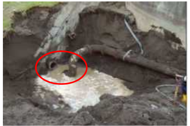
<場内配管渠被災状況(むかわ下水処理場)> (北海道むかわ町)
