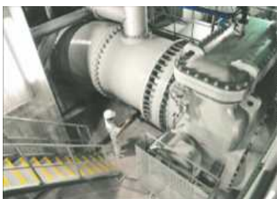
雨水ポンプ(広島市)
